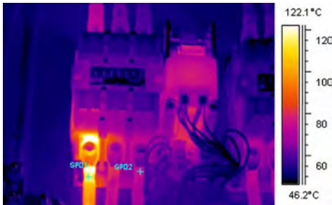
図 28.9 屋内電気設備の熱画像 (2)。
